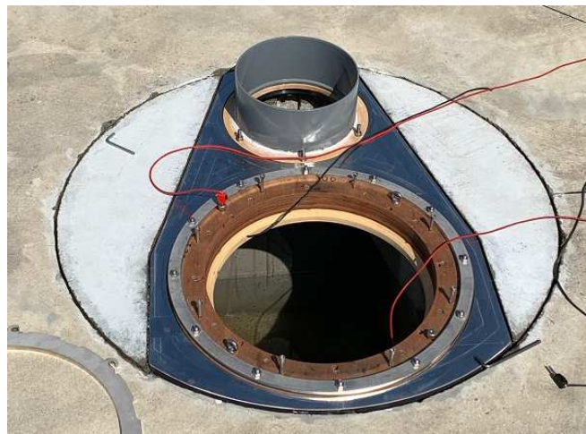
Figure 4 Installation de l'outillage d'interface pour HP de 46cm, ainsi que de la rondelle d'accueil des tronçons d'évent
